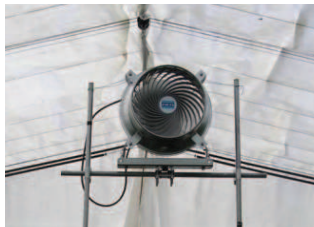
【〇】循環扇の設置によるハウスの省エネ対策
