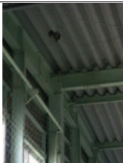
【○】防鳥ネットの設置
