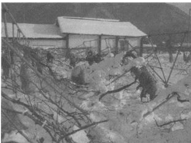
写真2 棚倒伏後の応急作業
