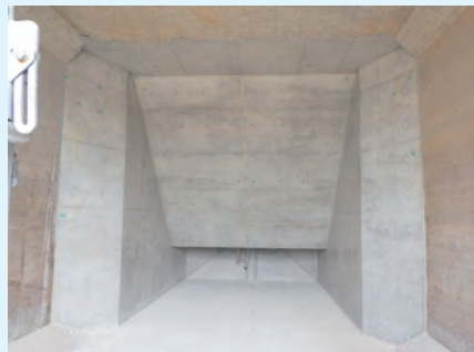
低水位での早期かつ迅速な稼働を可能とするセミクローズ吸水槽 (相之島機場)
