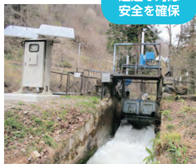
遠隔操作が可能となった水門 (飯綱町)
