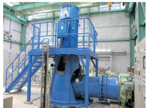
耐水化を実施した排水機場ポンプ設備
