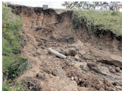
用水管の破管による農地の崩落
