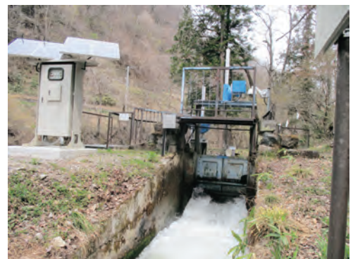
遠隔操作が可能となった水門
