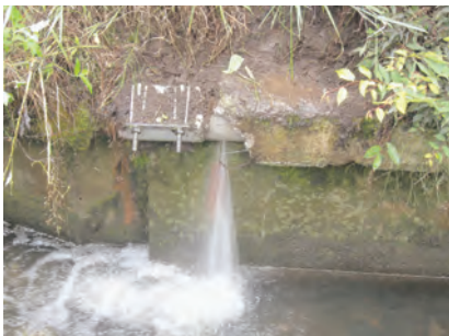
老朽化による用水管の漏水
