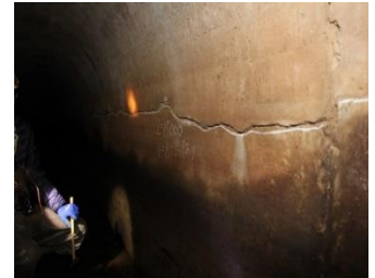
【芋川隧道の破損状況】
