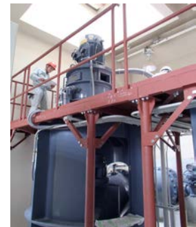
排水機場内設置された排水ポンプ
