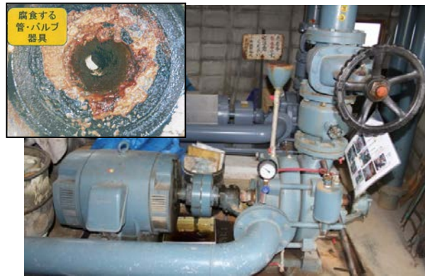
老朽化した揚水ポンプ
