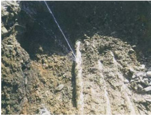
破管による漏水
