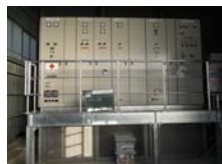
更新された電気設備
