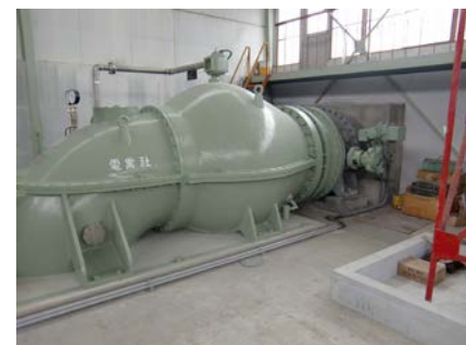
更新されたポンプ施設
