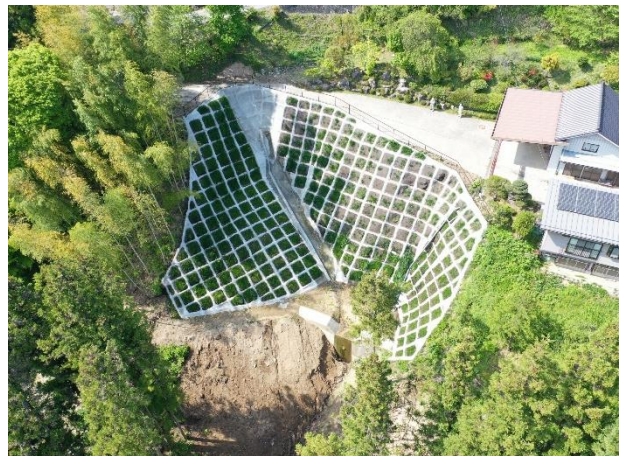
【崩落した法面の保護（阿南町）】
