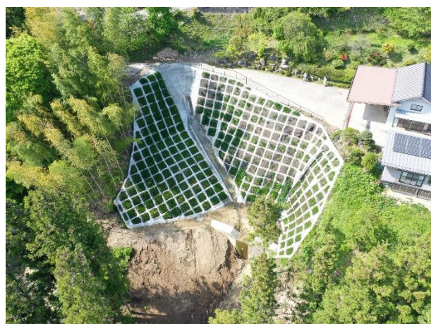
【崩落した法面の保護（阿南町）】
