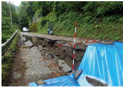
地すべり被災状況
