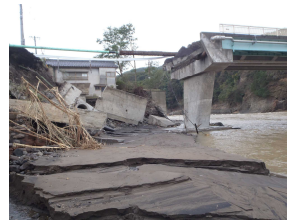
(主)丸子東部インター線 東御市 田中橋 (令和元年東日本台風)
