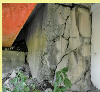
橋台のひび割れ
