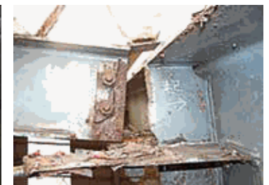
(スノーシェッド老朽化の状況)
