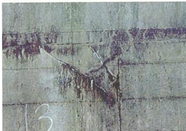
写真 2.1 ブロック化したひび割れの例 1)
