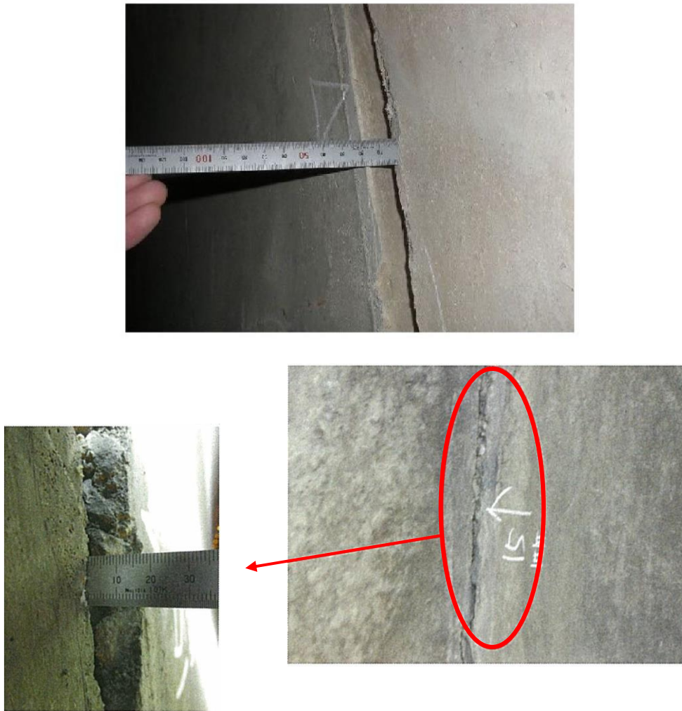
写真 1.9 段差の例 ①
