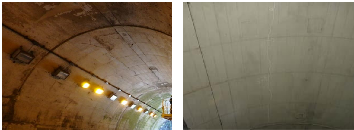
写真 1.4 覆工の天端付近に発生した縦断方向のひび割れの例 1)
