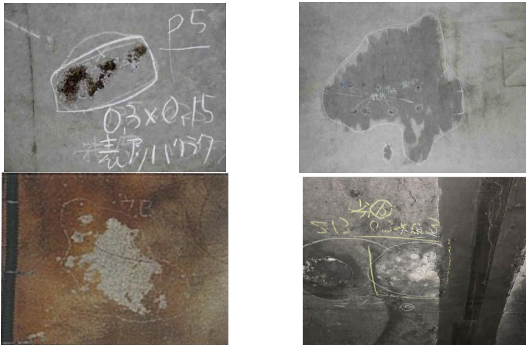
写真 1.7 覆工コンクリートが変色している例 1)
