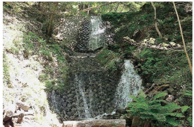
F5：杉ノ沢上流 えん堤間の水路部も石張であるが袖部が流水で洗掘されて、破損し始めている。
