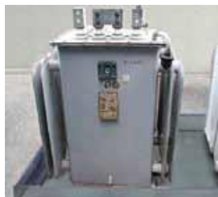
トランス (変圧器)
