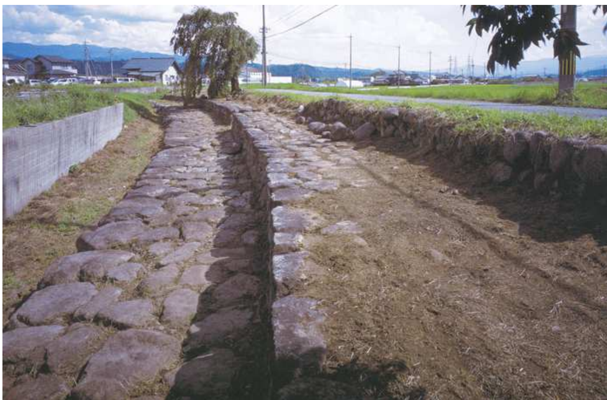
写真2 堤体：北から（左から下段、上段、明治元年の嵩上げ普請の道路面）
