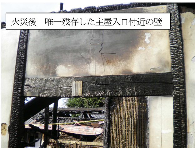
火災後 主屋中央から北方向を望む
