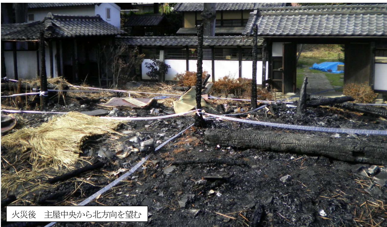
火災後 主屋中央から味噌蔵を望む
