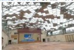
台風で屋根が消失した体育館
