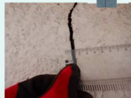
外壁のクラック
