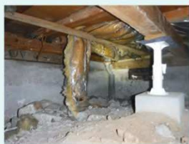
床下断熱材の剥離
