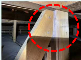
耐震金具がない
