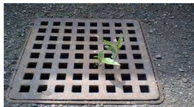
排水溝の水たまり
