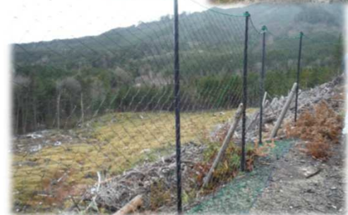
適切に設置された防護柵
