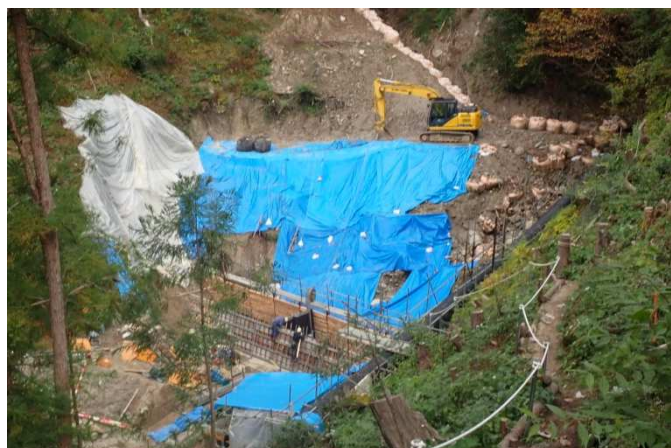
写真3 コンクリートを打ち込むために型枠を設置（工事は続く…）
