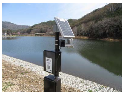
ため池監視システム（木祖村大平ため池）
