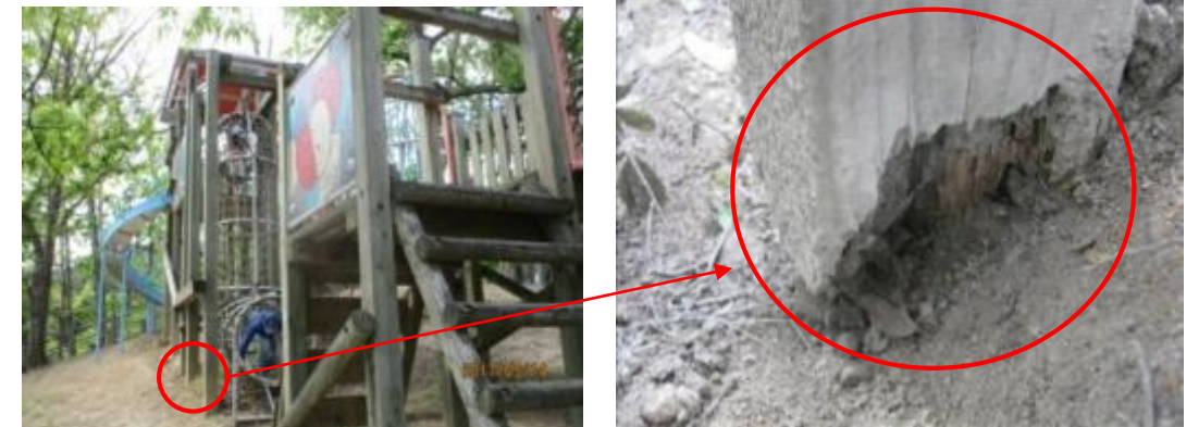
遊具の老朽化状況
