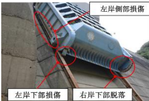
裾花ダム2号予備ゲートの老朽化状況
