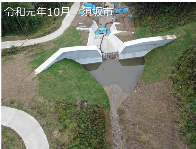
令和元年10月 須坂市 3か年緊急対策 により砂防堰堤を 前倒し で整備 令和元年東日本台風では、土砂及び流木を補足し、 土石流被害を防止
