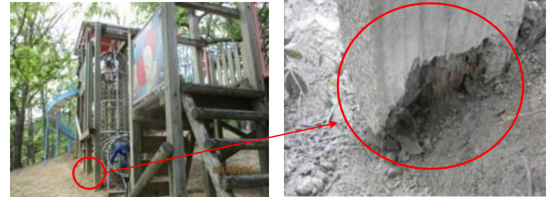
遊具の老朽化状況
