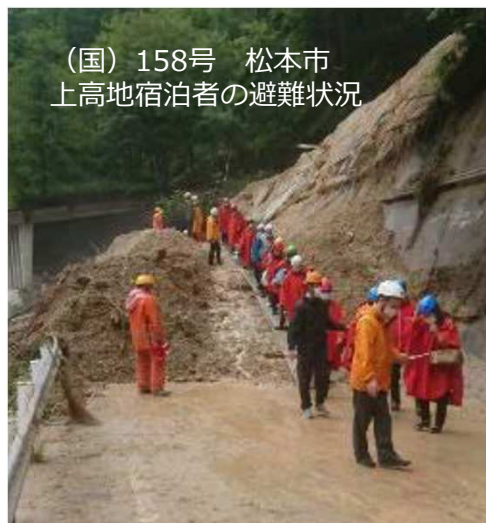
令和2年7月豪雨では、各地で土砂災害や道路の寸断により集落が孤立するなど、地域住民の生活に影響を及ぼした
