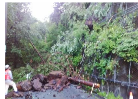
法面崩落による通行止め
