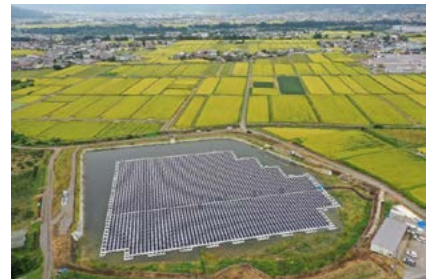
農業用ため池を活用した太陽光発電施設（上田市）
