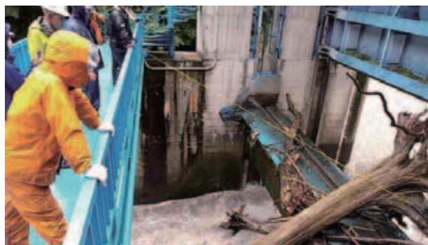
片平取水場の流木除去の様子 (令和2年7月豪雨時)
