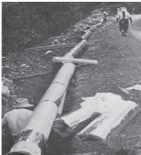
大町温泉引湯施設 (H11.4 移管)
