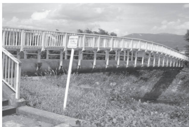
送水管(松塩) (H4.4.1 用水受水計画 81000m 3 /日 供給開始)
