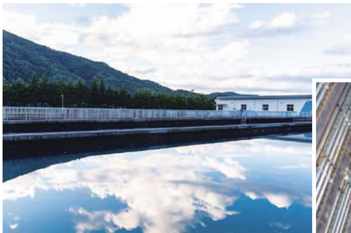
水を湛える本山浄水場沈殿池
