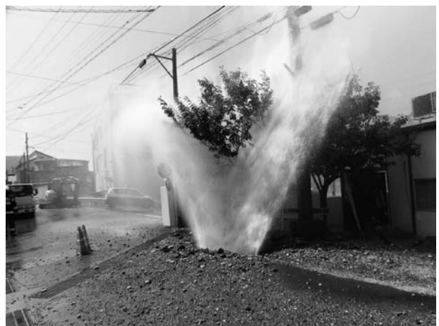
消火栓破損事故
