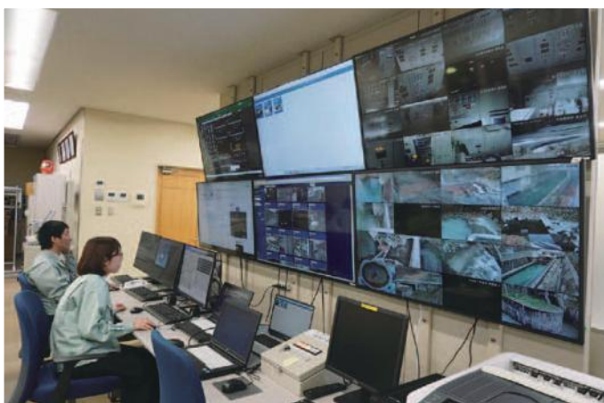
中央制御所での監視制御
