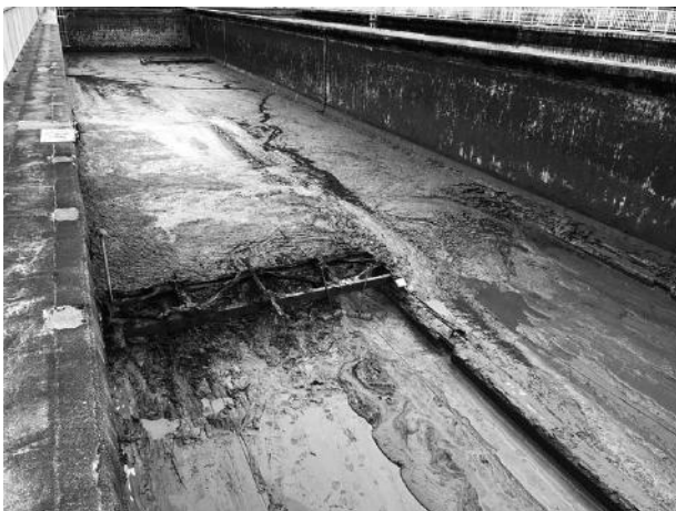
令和2年7月豪雨後 沈殿池
