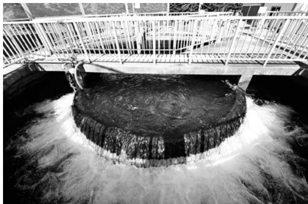
本山浄水場の着水井
