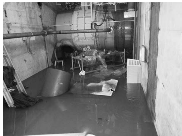
裾花発電所地下室浸水状況
