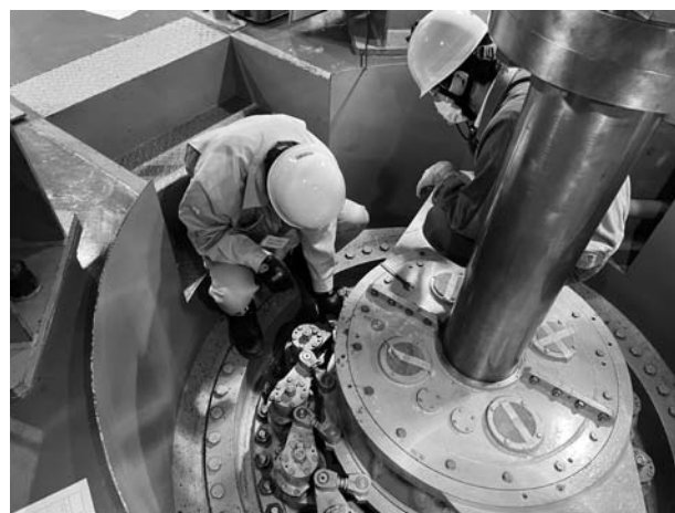
水力発電設備技術研修 弱点ピン取替
