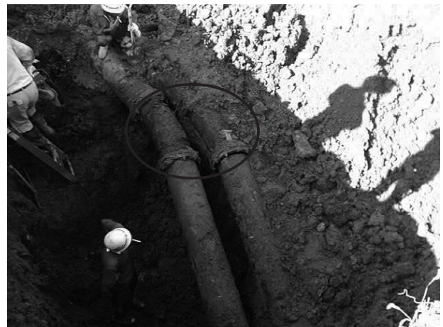
送水管・配水管の漏水箇所
