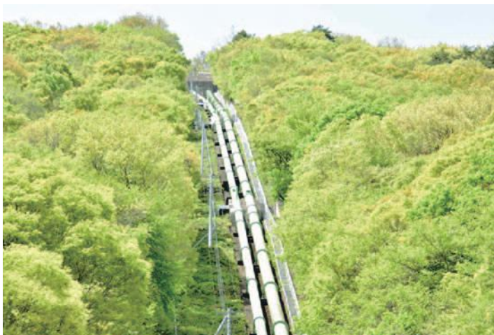
菅平発電所の水圧鉄管（上田市）
