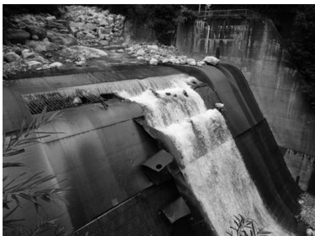
与田切取水口の被災状況
