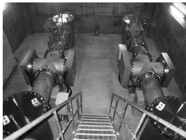
完成した紫外線処理設備
