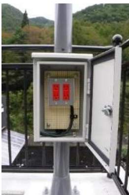
非常用コンセント
