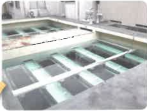
[ろ過池(更新前)]
