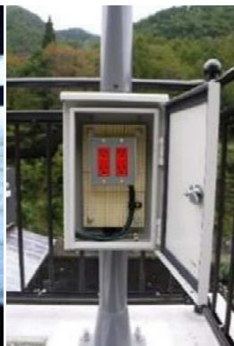
非常用コンセント
