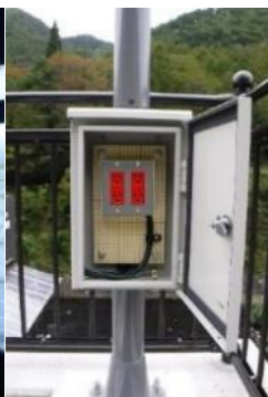
非常用コンセント
