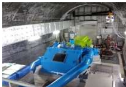
【水車及び発電機】
