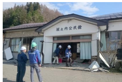
長野県神城断層地震（H26.11.22）
