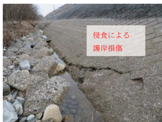
写真-3 侵食による護岸損傷(高瀬川)
