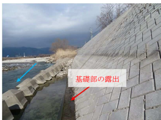
写真-2 洗掘による基礎の露出(高瀬川)
