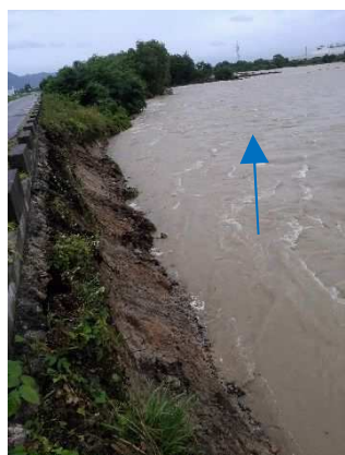
写真-4 池田町中之郷 被災状況 (平成 30 年 7 月)
