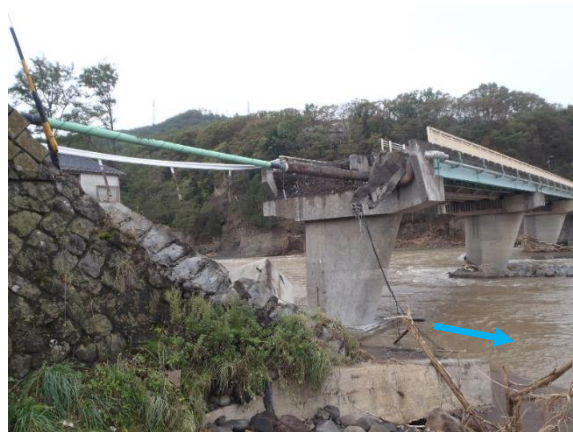
令和元年東日本台風(台風第19号) 千曲川の東御市田中橋での被災状況
