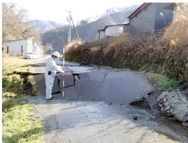
写真 1-5 平成 26 年（2014 年）の地震で発生した神城断層の変位（白马村塩島地区）
