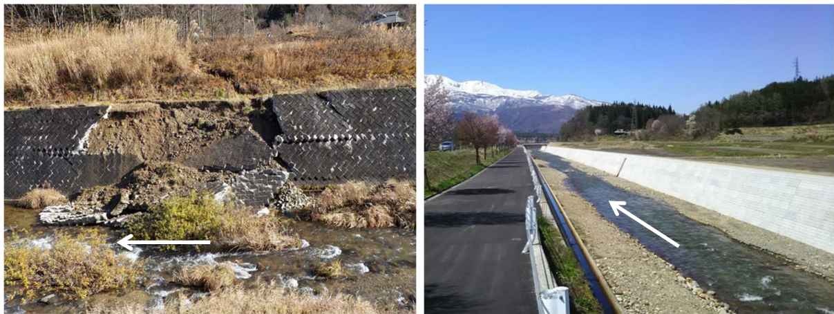
写真 1-12 平成 26 年（2014 年）の白馬村を震源とした地震（神城断層地震）による被害（左）と復旧後（右）
