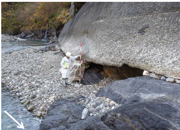
写真 1-9 河床侵食の事例
