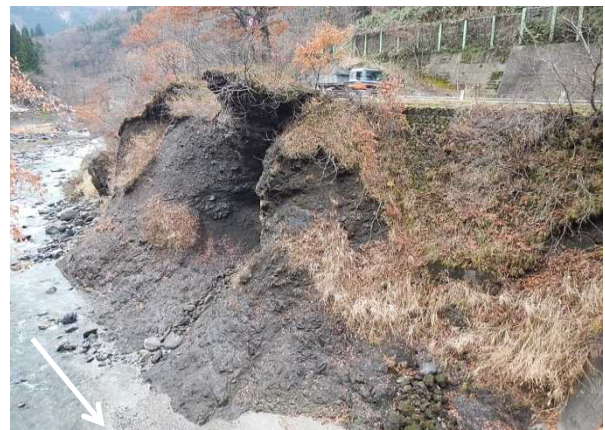
写真 1-10 溪岸崩壊の事例
