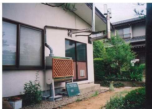
図 2.8.4 浅川流域内の雨水貯留施設設置状況
