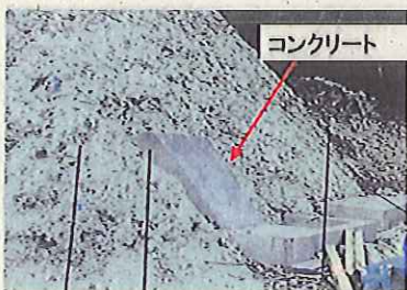
実際の掘削法面にコンクリートを打設して経過を観測しました。
