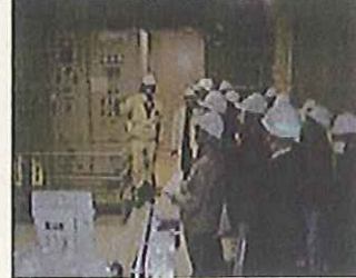
更級排水機場見学会 (千曲市八幡地区)(22年3月)
