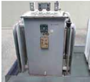
トランス (変圧器)
