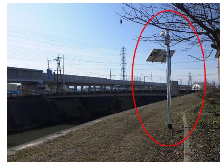
簡易型河川カメラの設置
