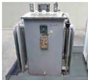
トランス（変圧器）
