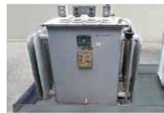
トランス（変圧器）
