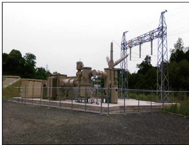
写真 1-6-3 送変電設備及び門型鉄構（イメージ）
