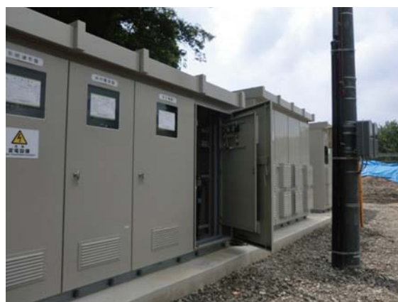
一次変電設備
