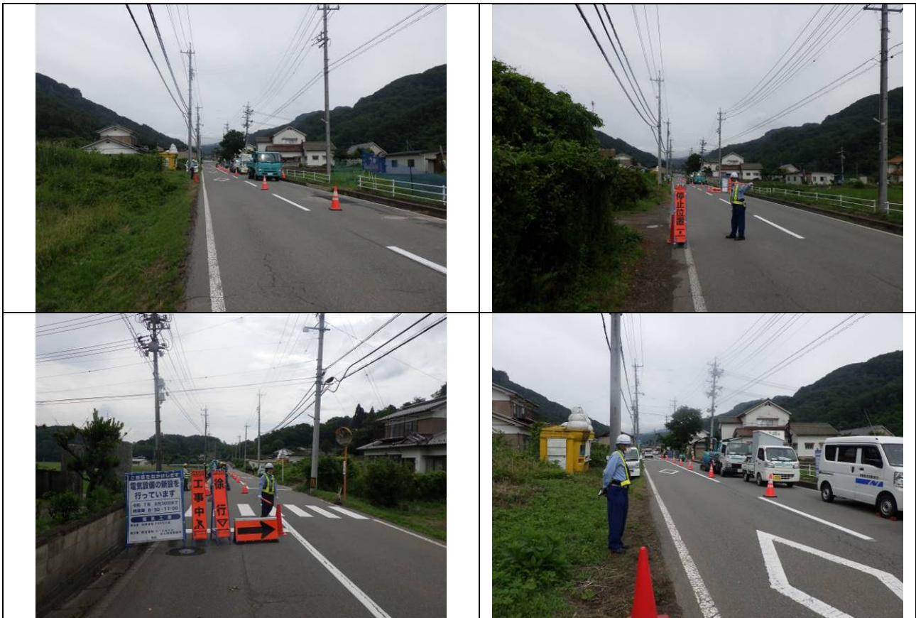
写真4-24：送電線の地下埋設工事区間における交通誘導状況（令和5年6月27日撮影）
